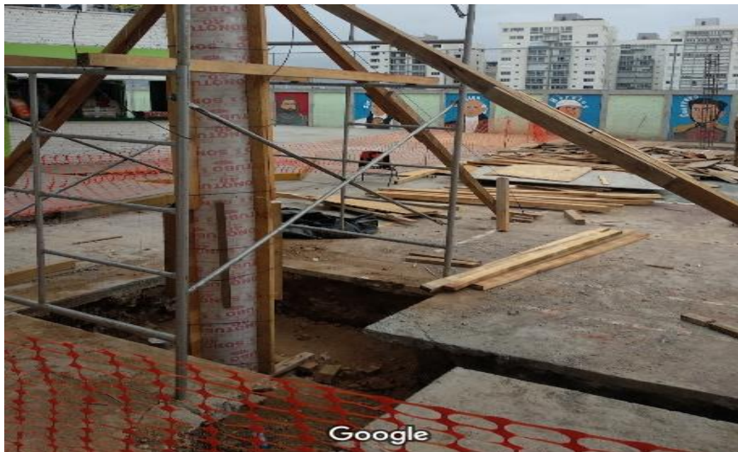
La construcción del domo, en el patio cívico de la institución, se convirtió en una dificultad para el desarrollo óptimo de las actividades académicas pero al final mejoró la infraestructura.
