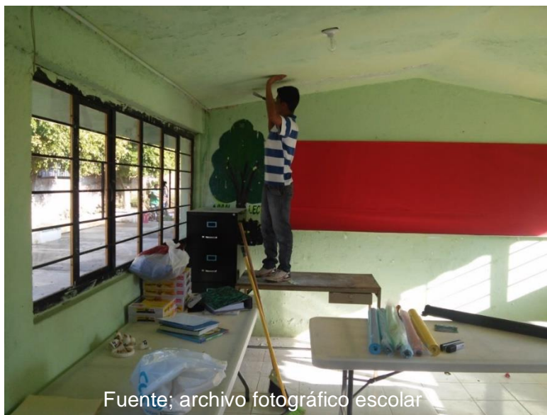
Fotografía No. 15 Padres de familia trabajando en la rehabilitación del edificio escolar
